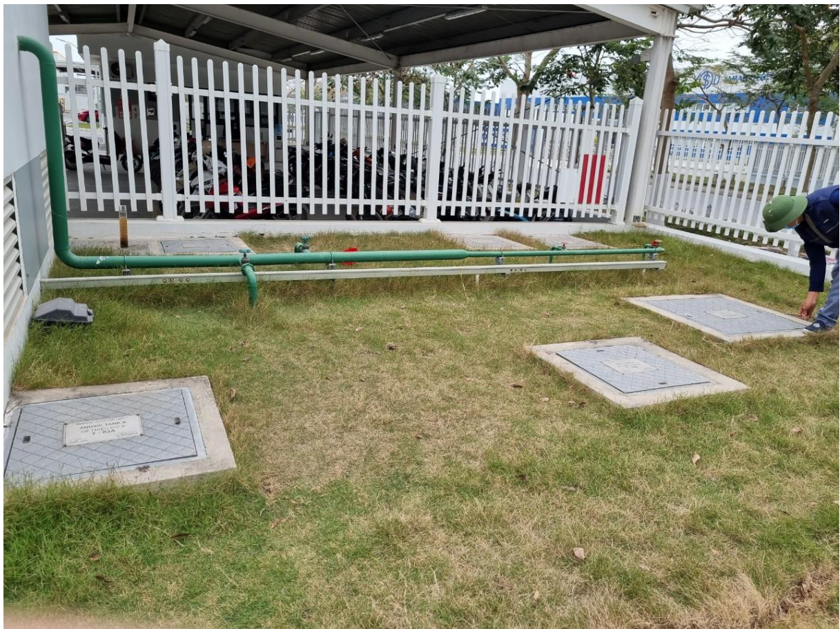
Hình 3. 8. Hệ thống xử lý nước thải sinh hoạt
