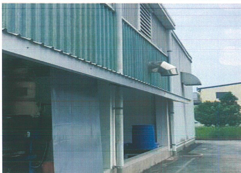
Hình 3- 10: Hình ảnh hệ thống thu gom và thiết bị hấp phụ tại hệ thống xử lý khí thải của 12 bể trộn
