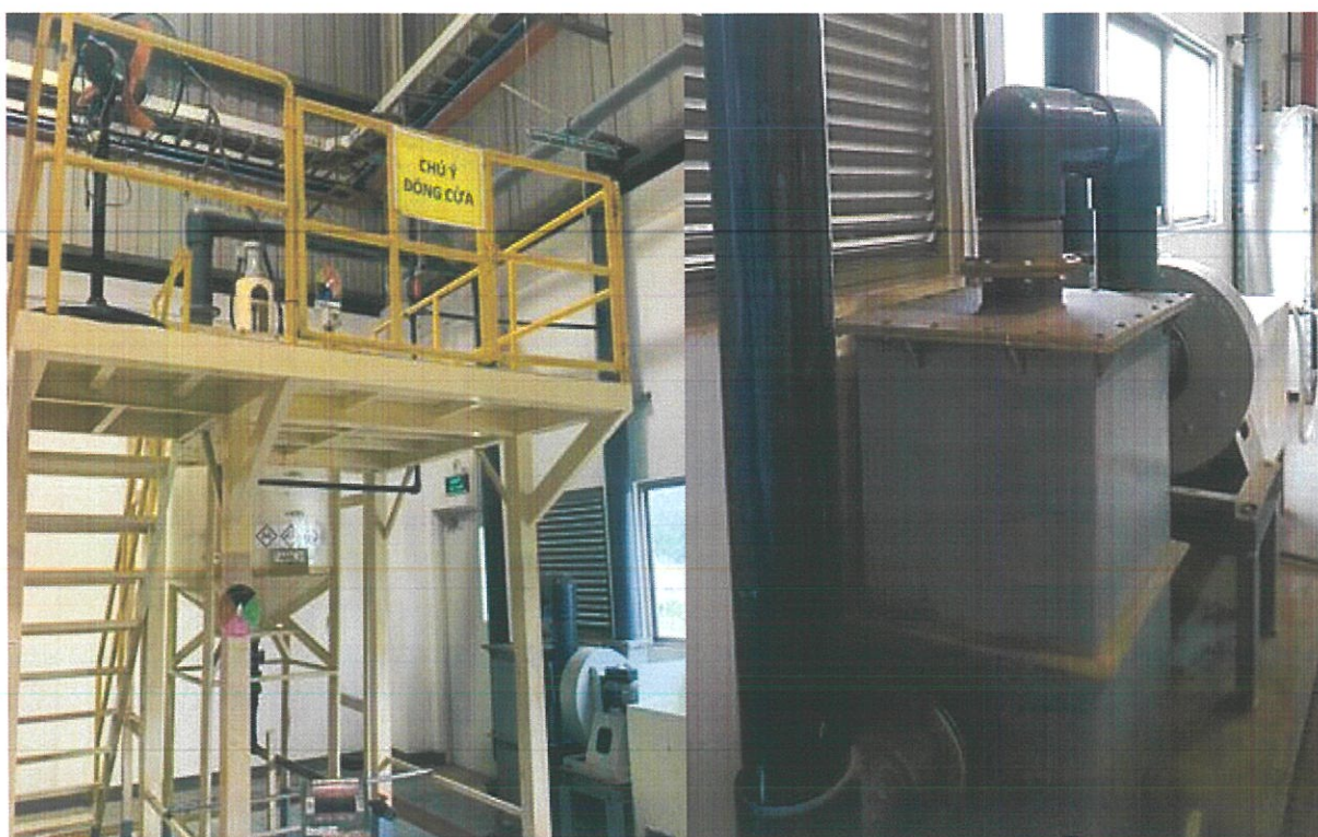
Hình 3- 11: Hình ảnh hệ thống thu gom và xử lý khí thải của tank trộn
