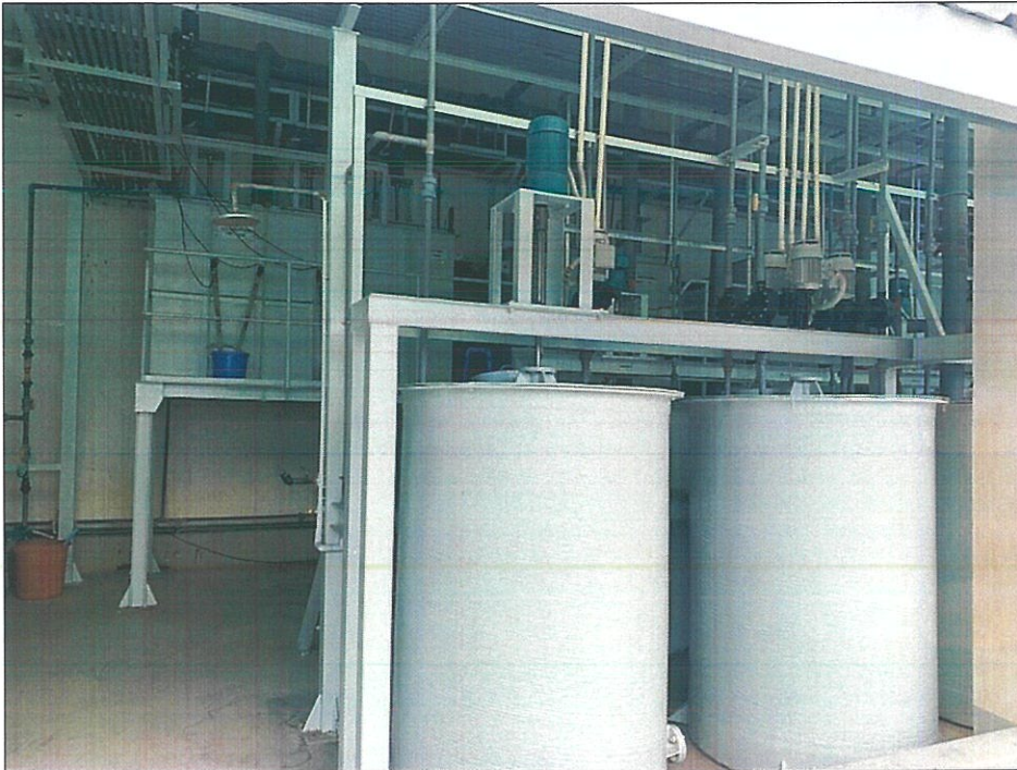
Hình 3- 7: Hình ảnh hệ thống xử lý nước thải sản xuất tại nhà máy
