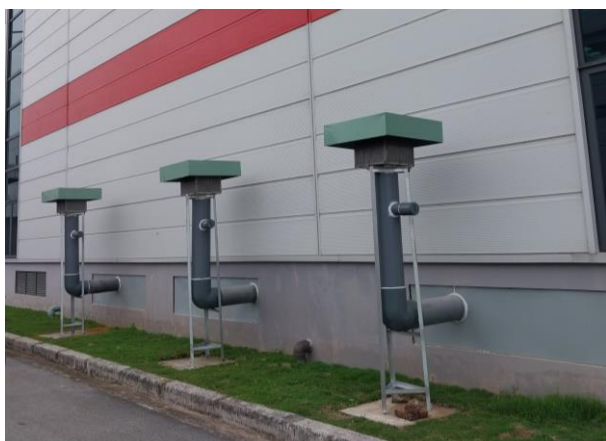
Hình 3: Hình ảnh 03 ống thoát khí của nhà máy
