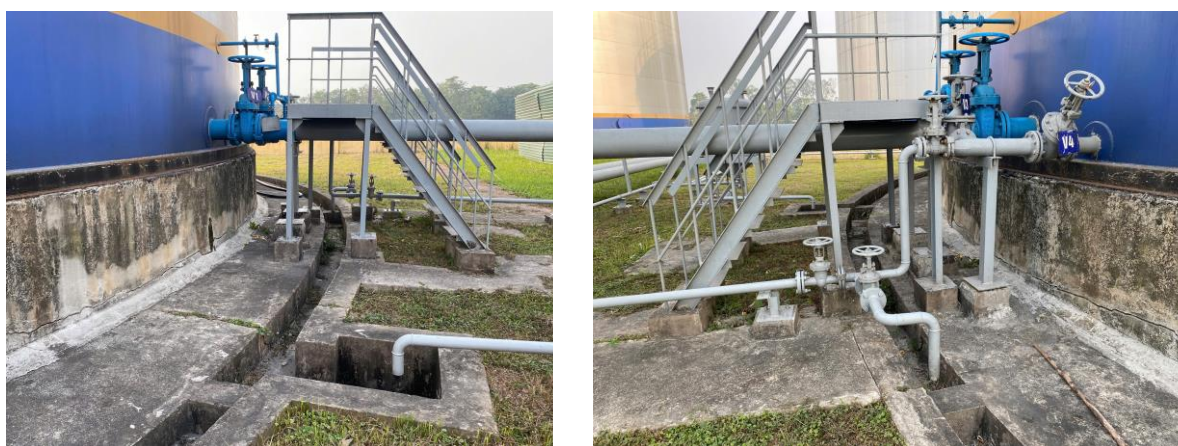
Hình 3.2. Rãnh và hố thu gom nước nhiễm dầu
