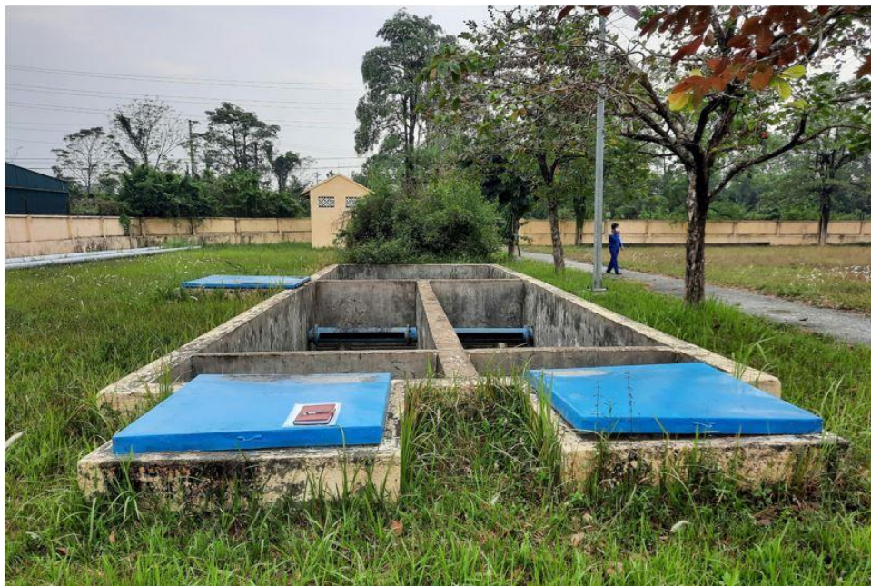
Hình 3.4. Bể tách xăng dầu, bể lắng cặn, hố thu dầu
