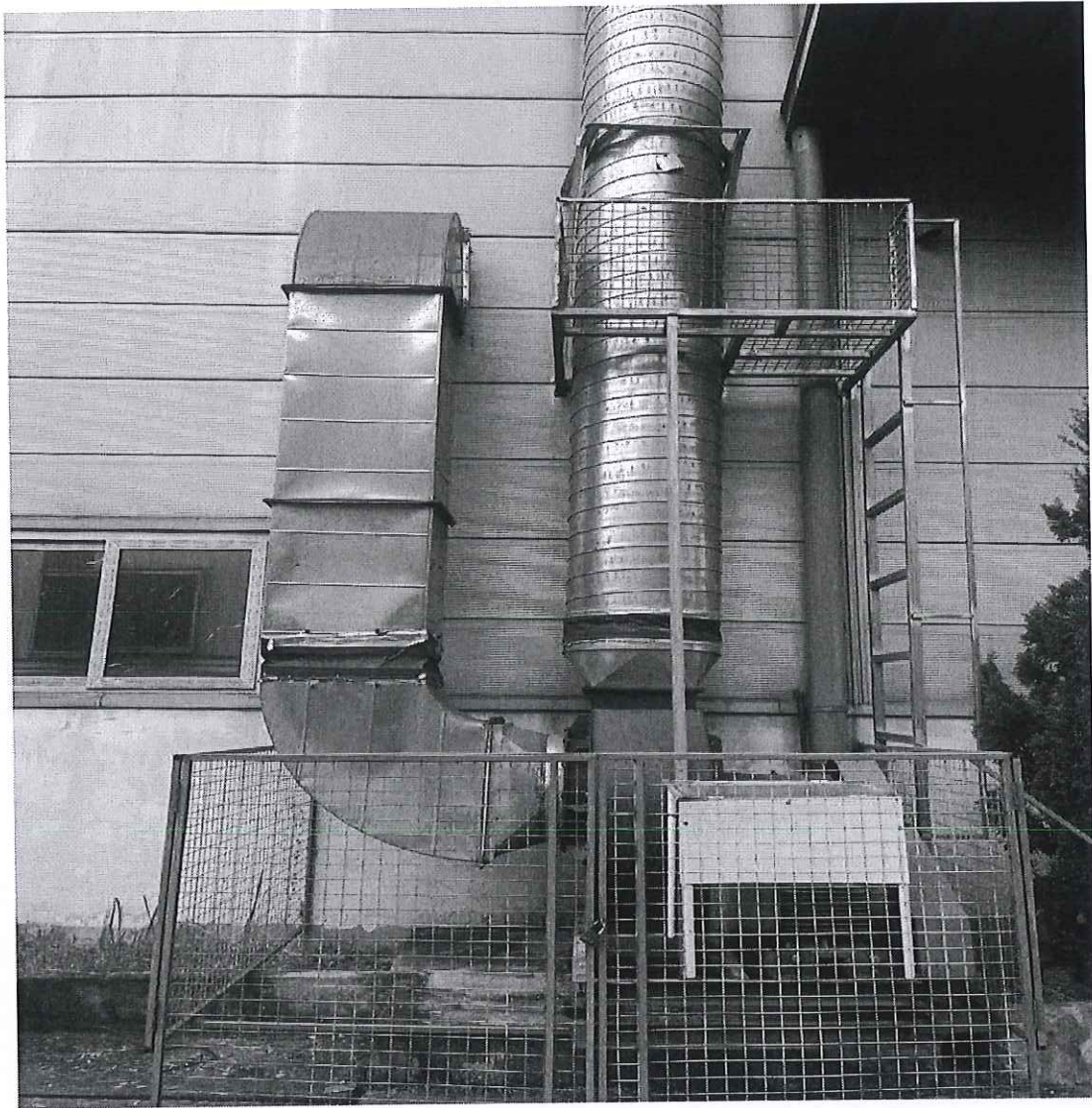
Hình 9. Hình ảnh hệ thống xử lý khí thải tại Nhà máy
