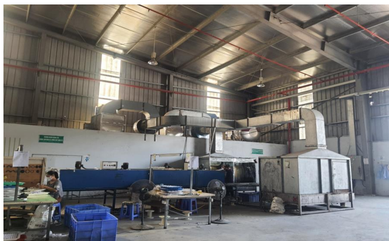
Hình 3.10. Hệ thống thu gom bụi, khí thải từ hoạt động phun sơn
