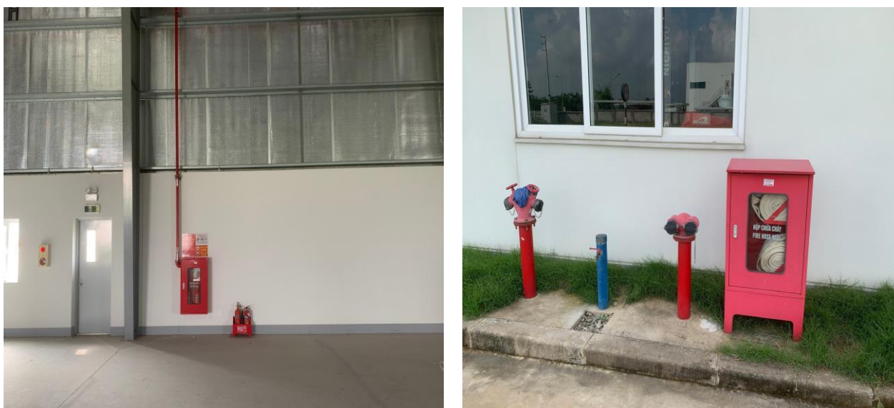
Hình 19: Hệ thống chữa cháy
