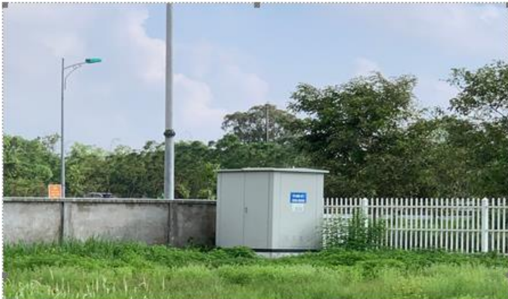
Hình 9: Trạm biến áp
