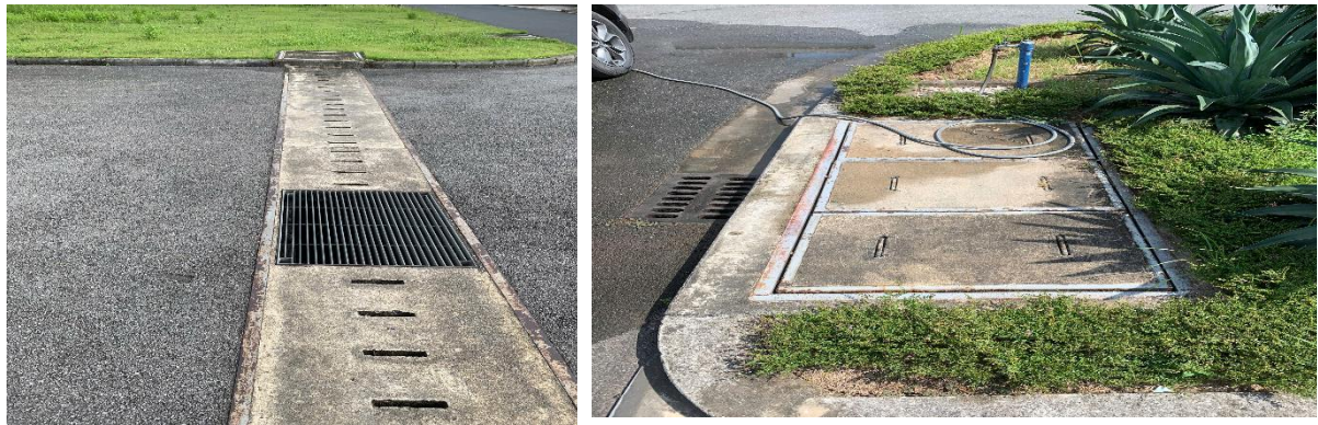
Hình 1. 7. Hệ thống thu gom nước mưa
