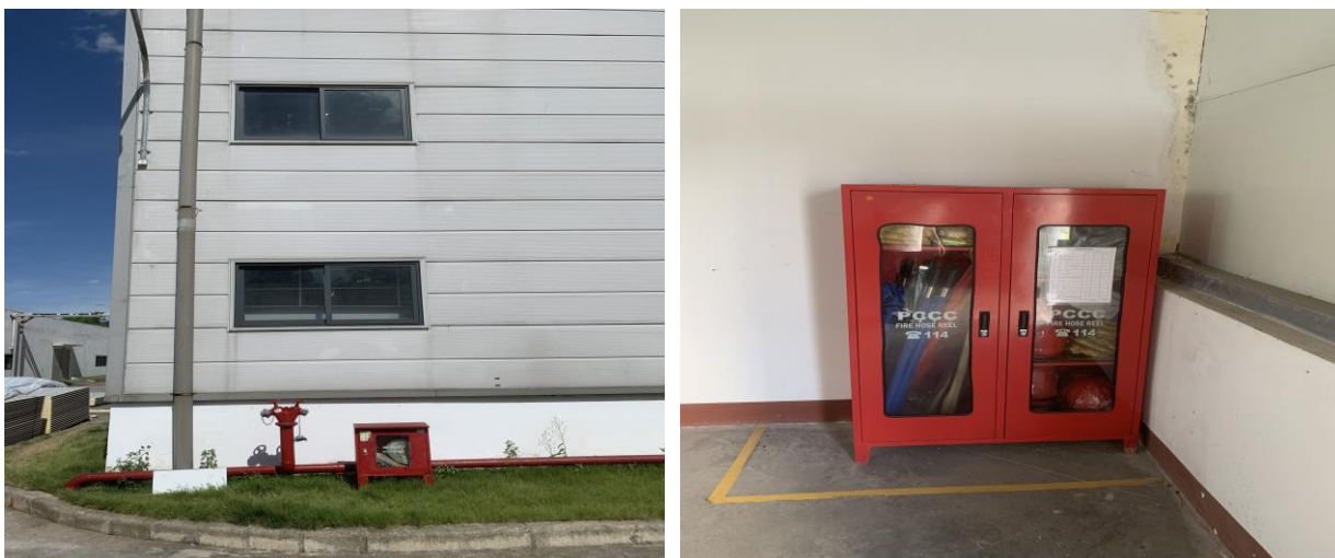
Hình 1. 23. Hệ thống chữa cháy của nhà máy
