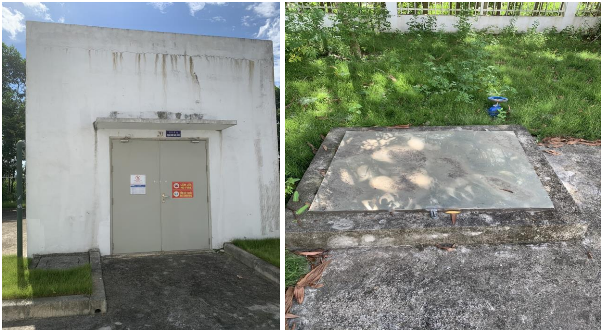
Hình 1. 10. Phòng bơm và bể chứa nước của nhà máy.
