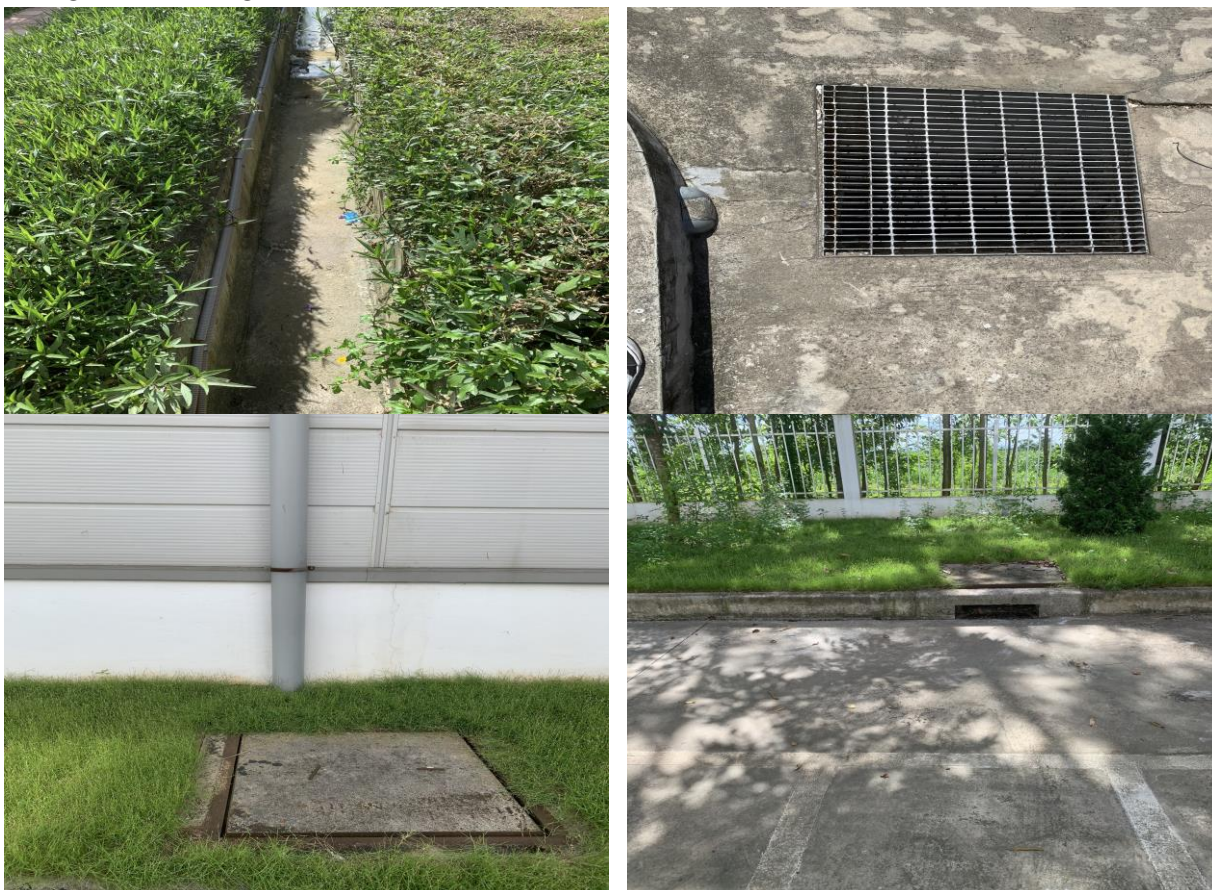
Hình 1. 21. Hệ thống thu gom nước mưa
