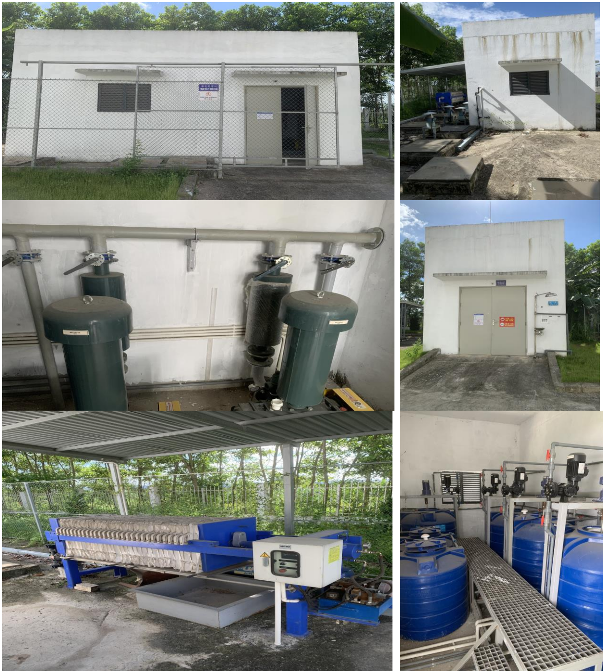
Hình 4. 7. Hệ thống xử lý nước thải của nhà máy
