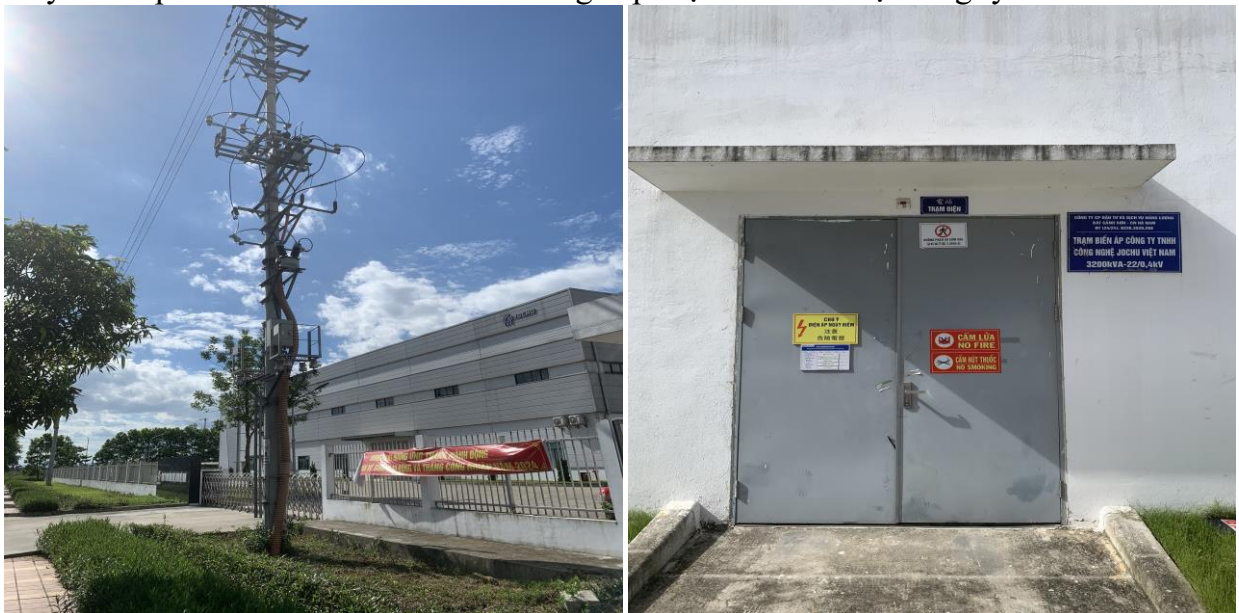
Hình 1.8. Trạm cấp điện và hạ thế tại nhà máy
