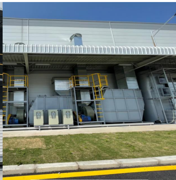
Hệ thống xử lý khí thải từ công đoạn sơn
