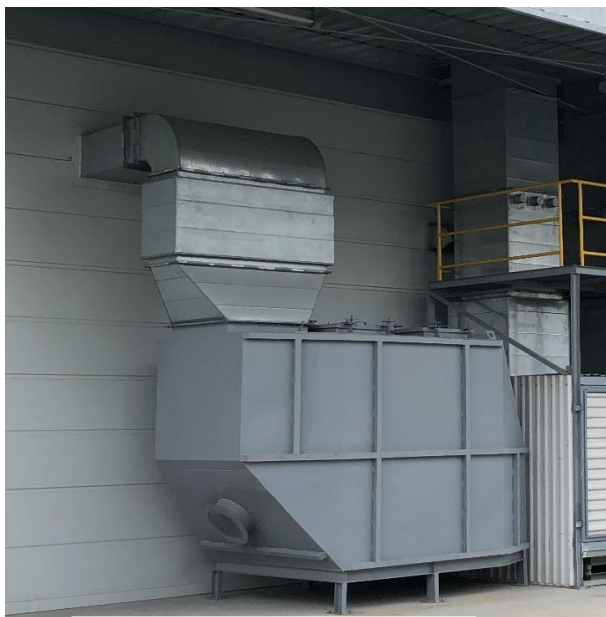
Hệ thống xử lý khí thải từ công đoạn sấy, đóng gói
