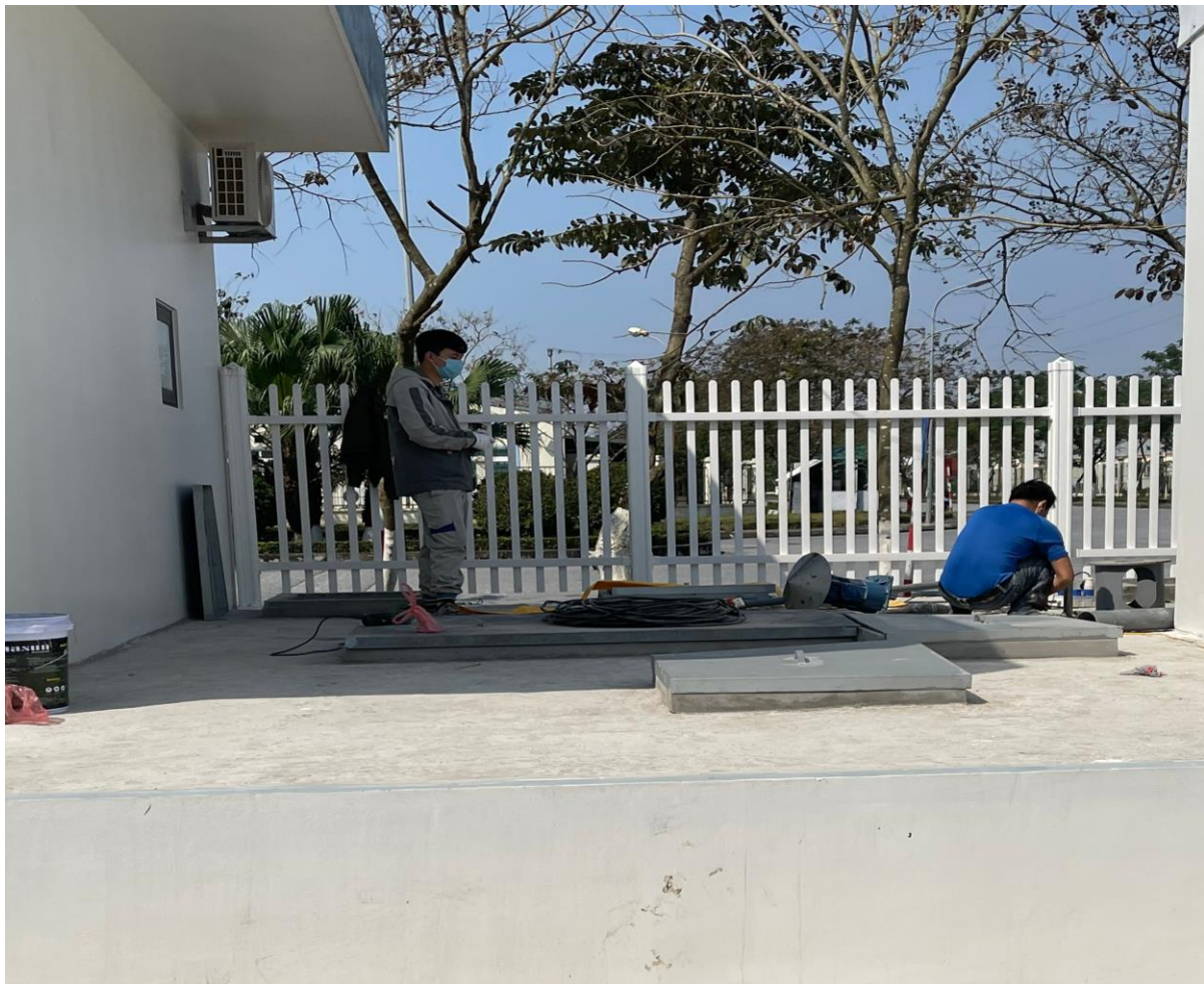
Hình 4.9. Khu vực xử lý nước thải tập trung nhà máy
