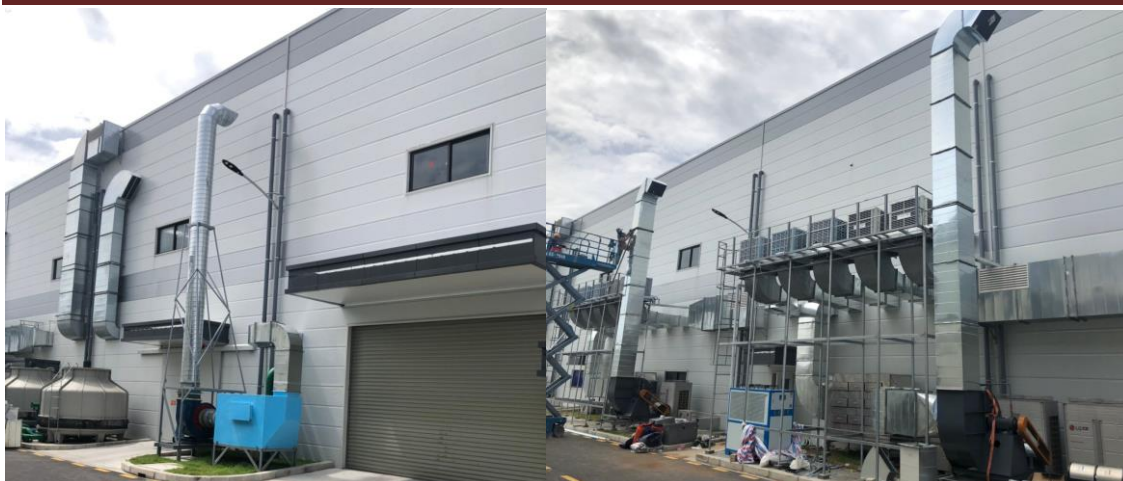
Hệ thống xử lý khí thải từ công đoạn dập ép
