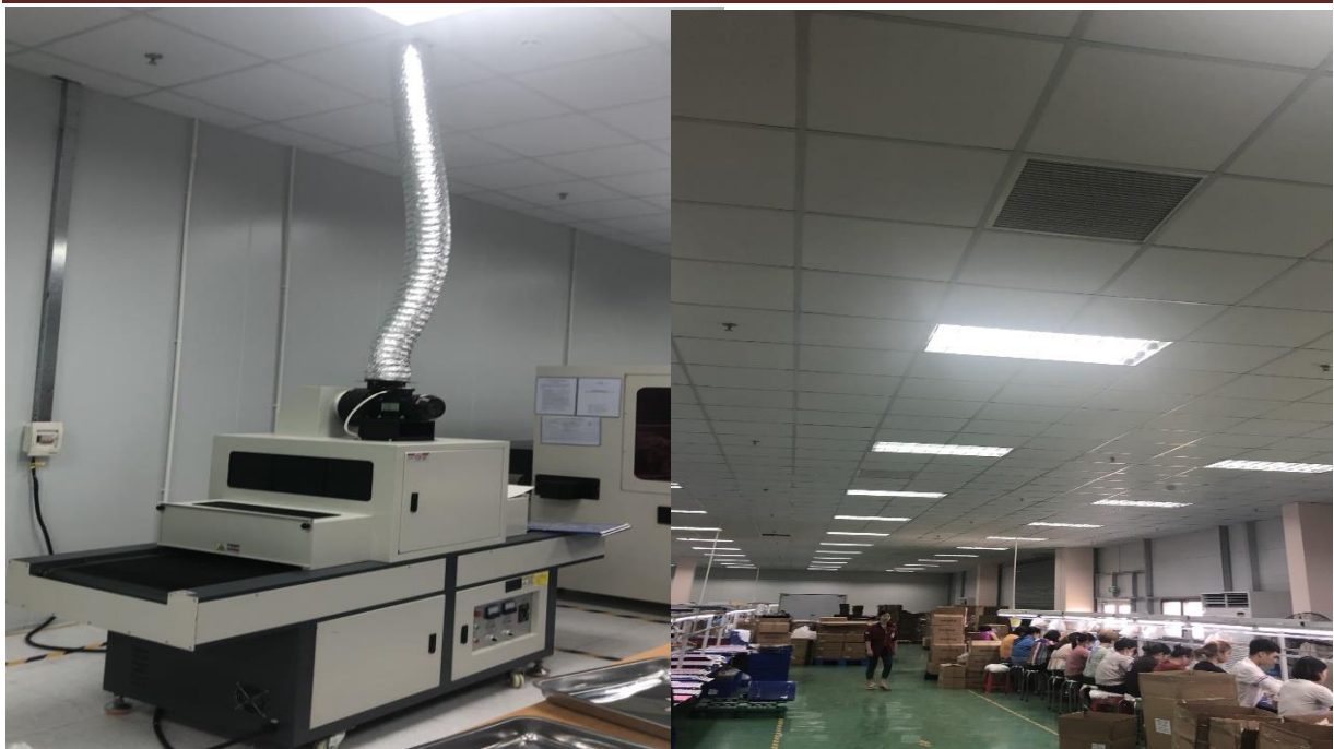
Hình 3. 1. Hệ thống thu gom khí thải từ khu vực sấy, đóng gói
