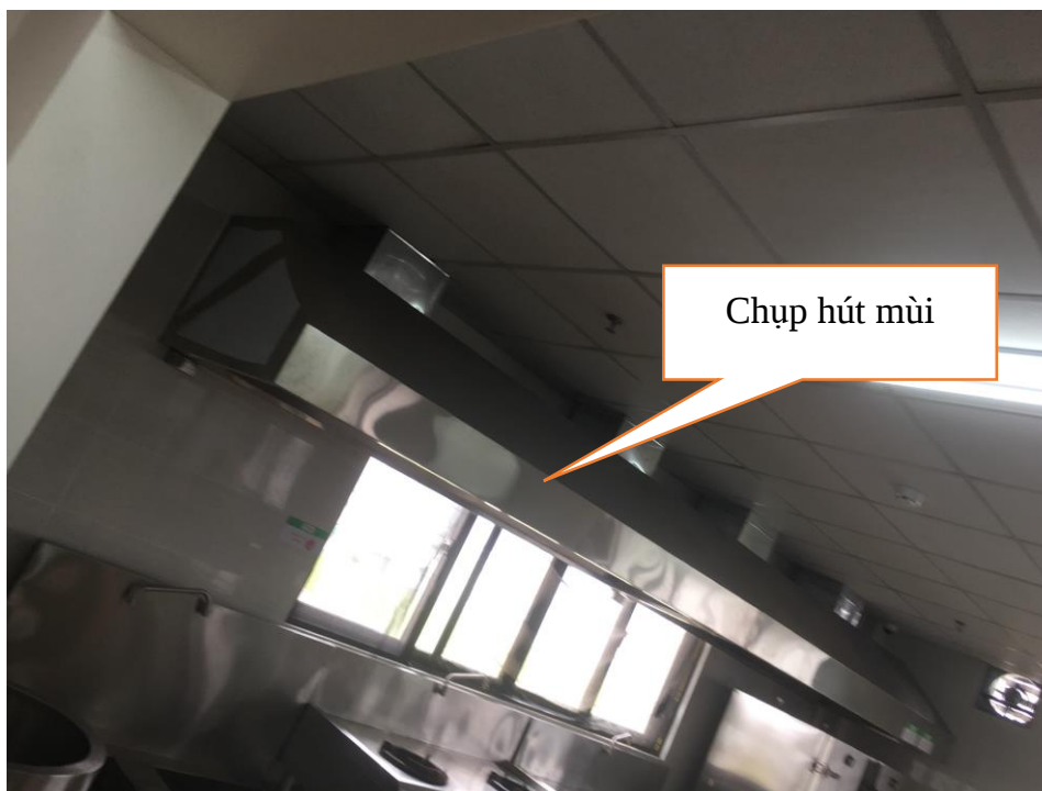
Hình 4. 19. Hệ thống xử lý mùi tại khu vực nhà ăn
