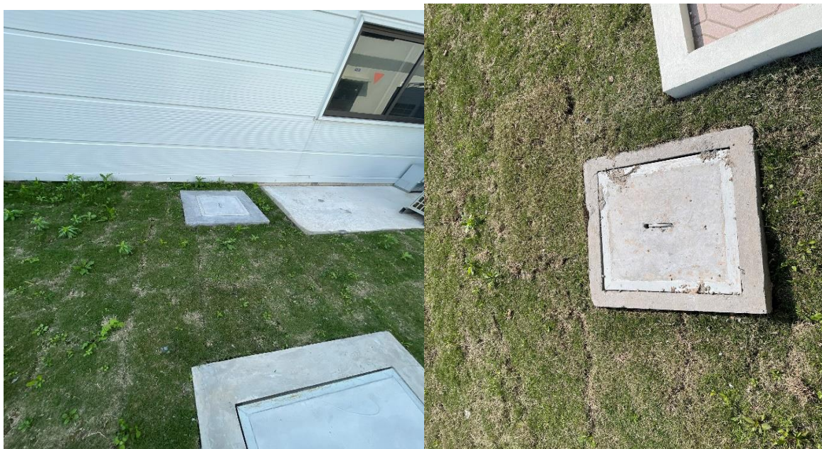
Hình 4. 3. Hố ga thu gom nước thải của nhà máy
