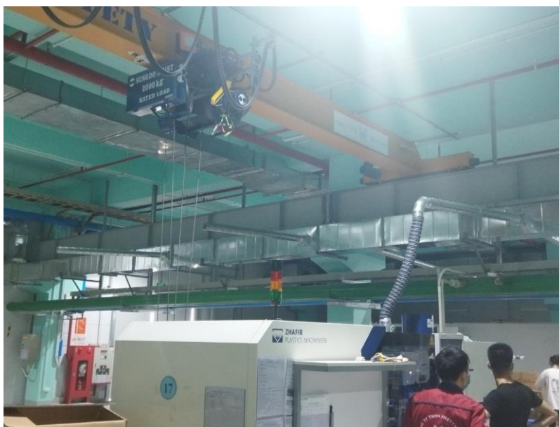
Hình 4. 13. Hệ thống thu gom, xử lý khí thải từ khu vực dập, ép
