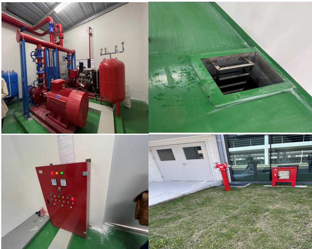
Hình 4. 24. Hệ thống PCCC của nhà máy
