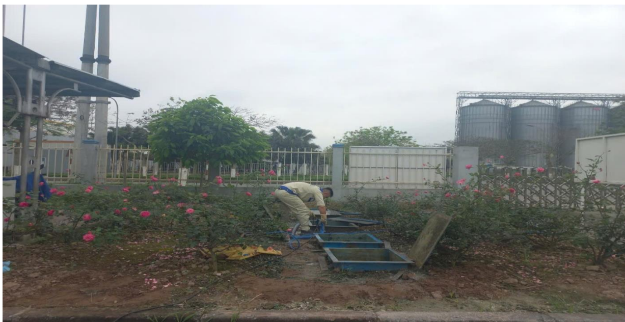
Hình 3. 5: Hình ảnh hệ thống xử lý nước thải công suất 10 m 3 /ngày.đêm của Công ty Công ty TNHH kỹ thuật nhà xưởng Kokyo Việt Nam
