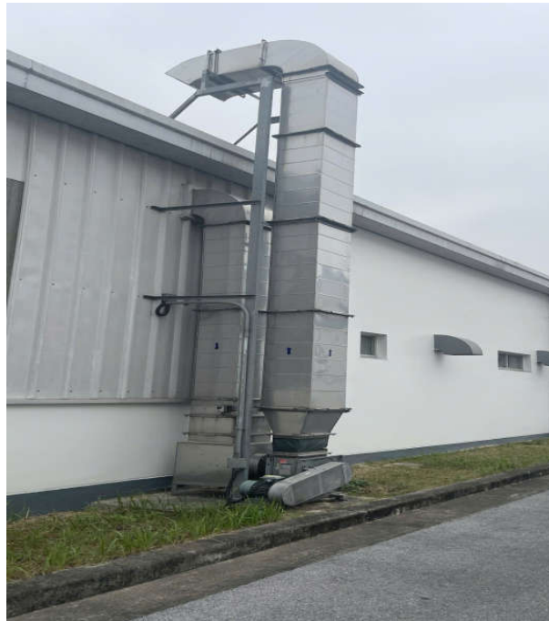
Hình 12. Hình ảnh hệ thống xử lý khí thải tại nhà máy
