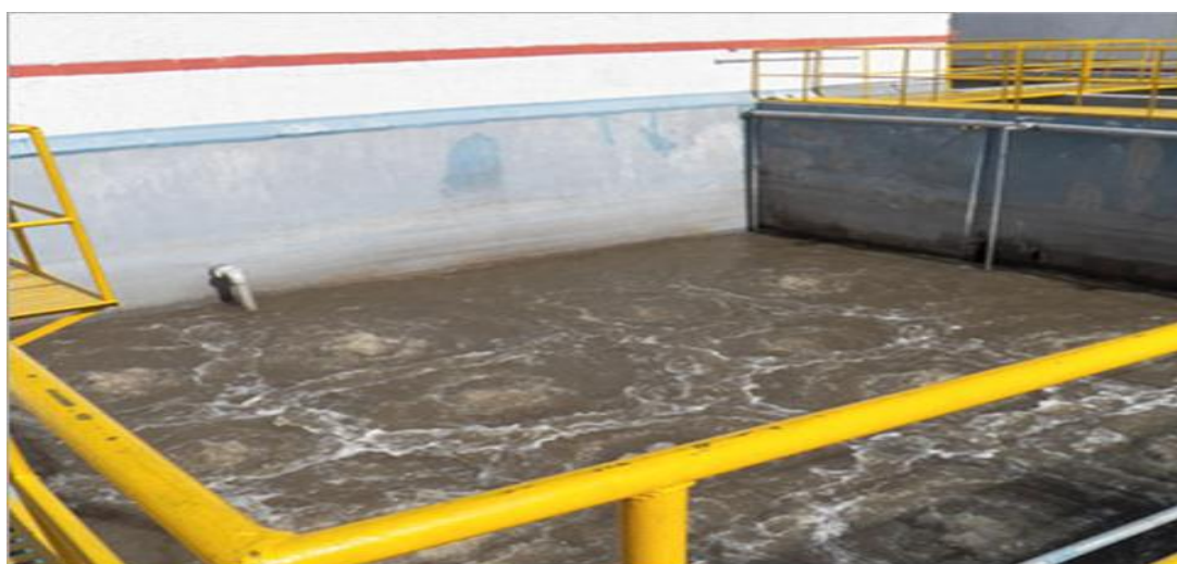
Hình 8. Bể điều hòa nước thải
