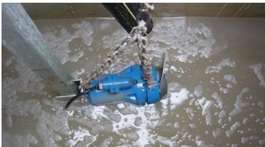
Hình 9. Máy khuấy chìm bể thiếu khí
